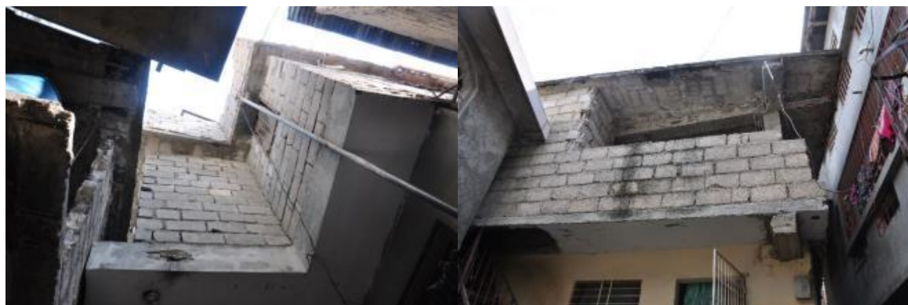
Etages supplémentaires mal-construits
