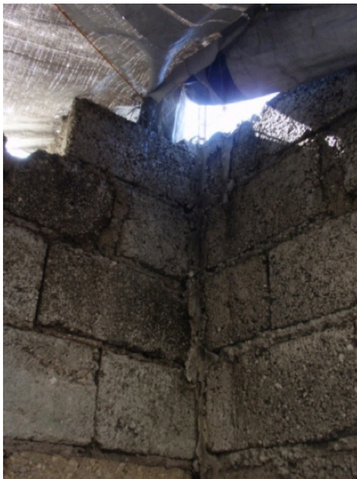
Un manque de chaînage supérieur horizontal
